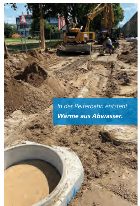
Inbetriebnahme der Power-to-Heat-Anlage in der Heinrich-Mann-Straße (Dezember 2021)
